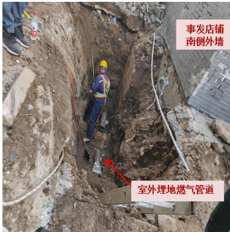
图 5 发生泄漏的燃气管道现场
