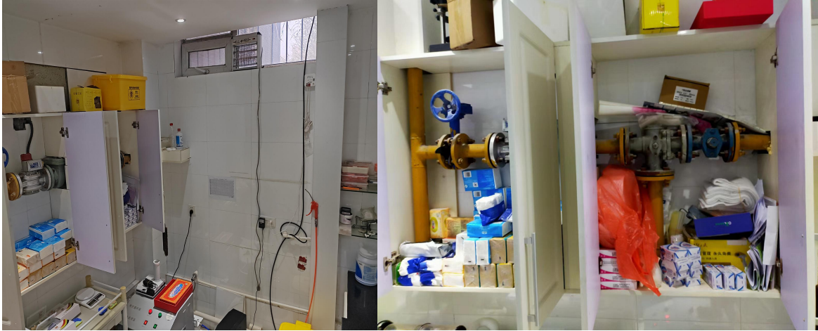
图 3 图 4 牙科诊所内的燃气管道阀门情况
