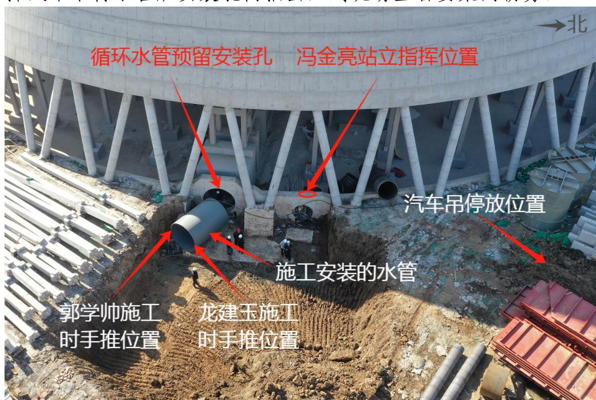
图3 事故现场航拍照片
