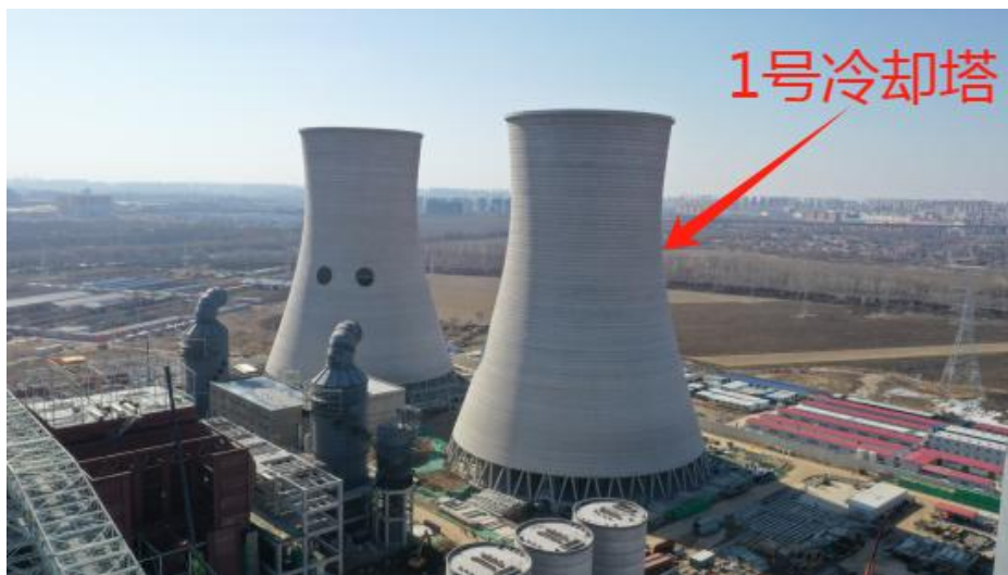
图2 B标段冷却塔
