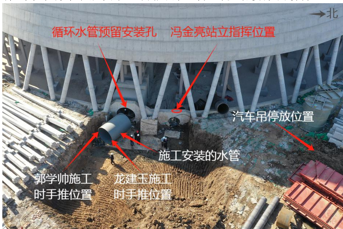
图3 事故现场航拍照片
