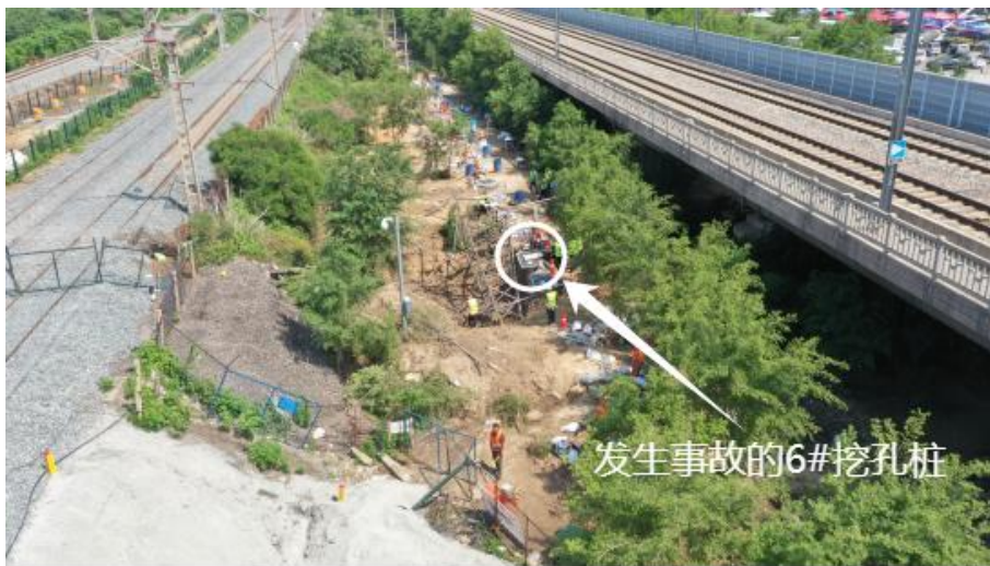
图5 事故现场航拍照片
