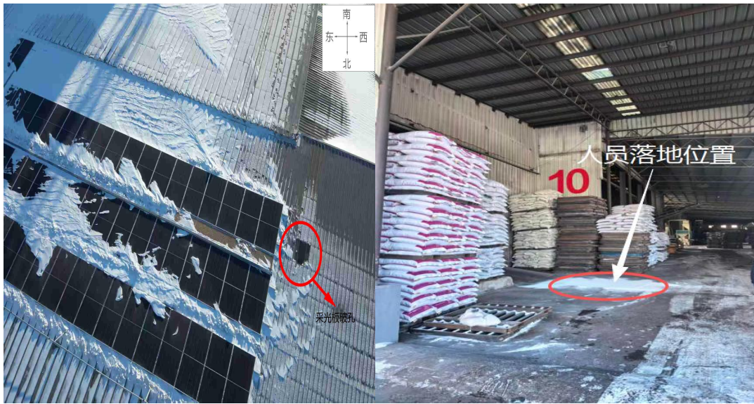
图2 图3 事发厂房采光板破孔
