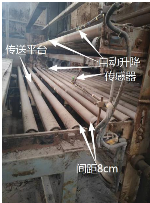
图 2 事故发生位置照片
