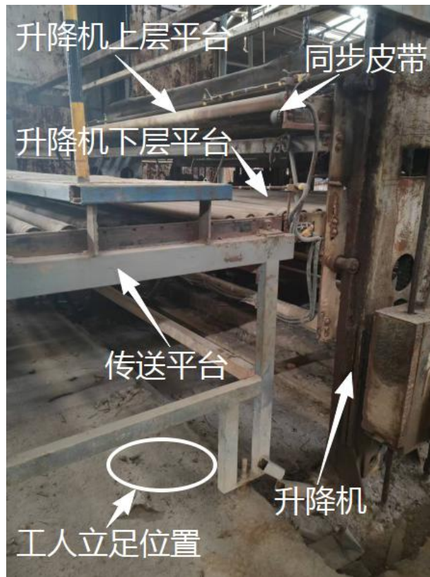
图 1 事故发生位置照片
