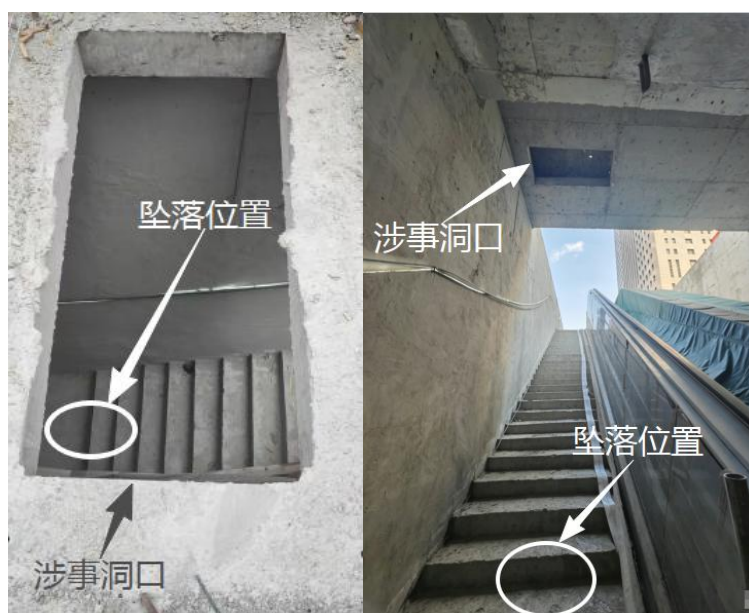
图 5 图 6 涉事洞口及坠落位置照片
