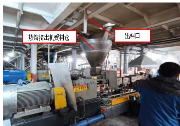
图 2 普混机底层热熔挤出机及冷却、切粒装置
