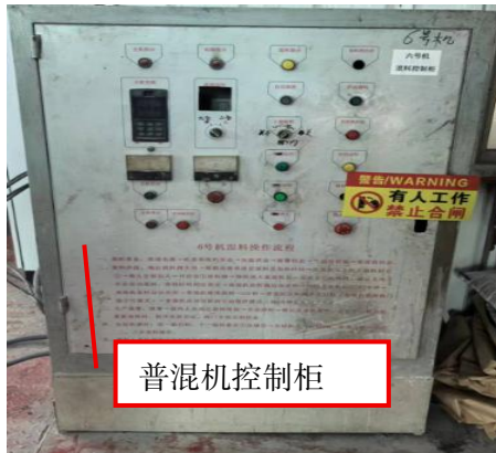
图 3 普混机上层动力电源控制柜
